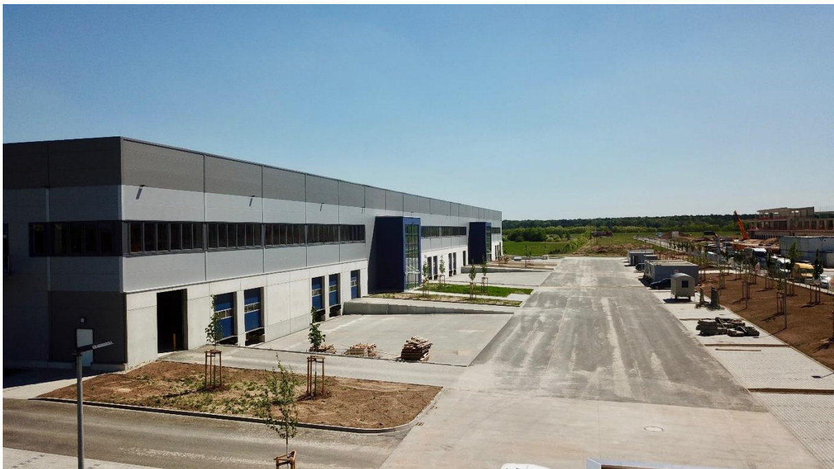
Bild: M-Port 3 (Quelle: MP Holding GmbH)
